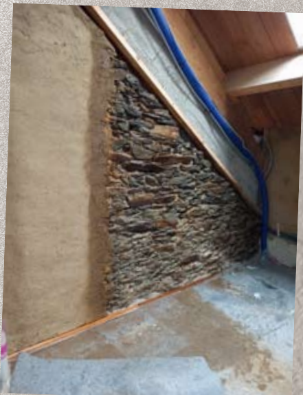
Humidification du mur
