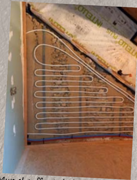
Mur chauffant de la salle de bain
