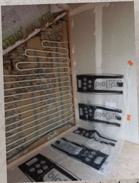
Mur chauffant de la chambre 1
